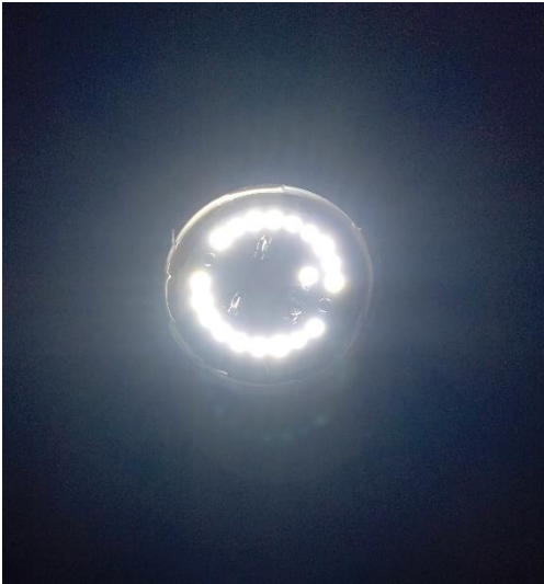
Gambar 2.5 Pengecekan lampu yang sudah diperbaiki
